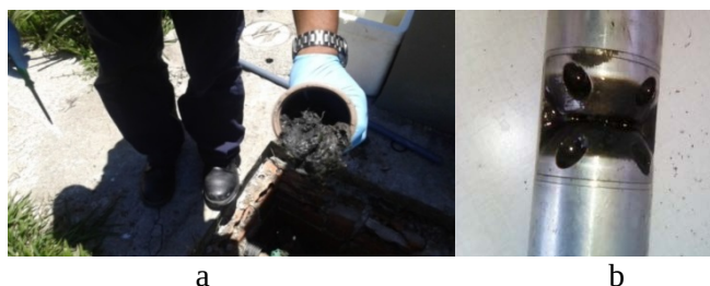
Figura 5. Depósitos de sólidos que se acumulan en a) válvula de retención y b) ventana de medición de la sonda.
